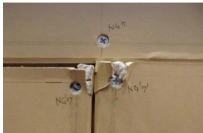
(d) Gypsum board joint damage (1/50 rad)
