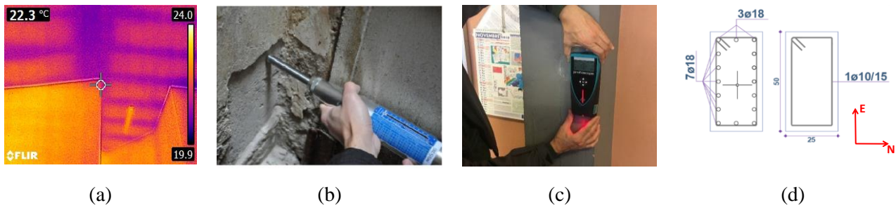
Fig. 3 - Thermal camera test (a), sclerometer test (b), pachometer test (c), and column cross section (d)
