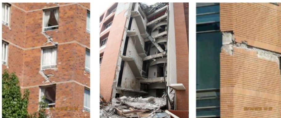
Fig. 7. Damage patterns in Ciudad Empresarial.
